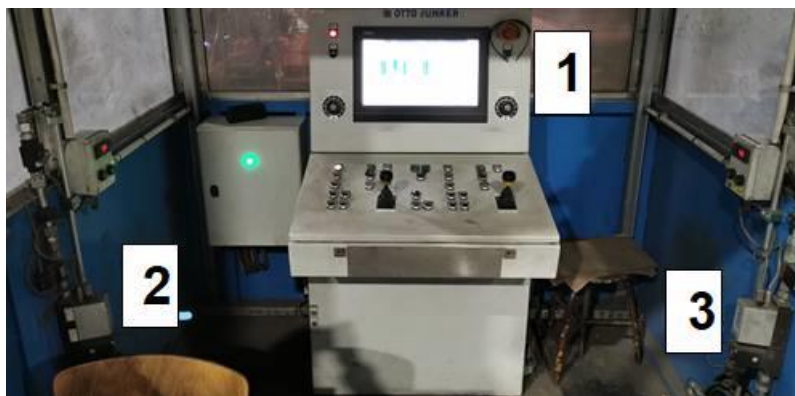
Rys. 2.2. Instalacja do dozowania azotu w piecach indukcyjnych, 1. pulpit sterowniczy, 2.3. regulator przepływu
