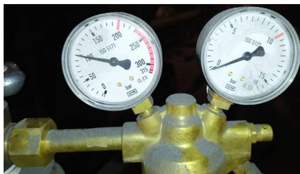
Rys. 2.14. Reduktor ciśnienia gazu zamontowany na głowicy butli z azotem
