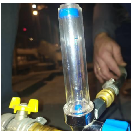
Rys. 2.15. Przepływomierz zamontowany na lancy
